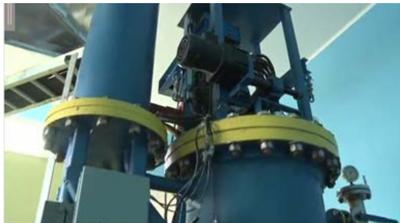
uno scorcio dell’ impianto Adronico in funzione a Benevento, Reg. Campania – Italia
