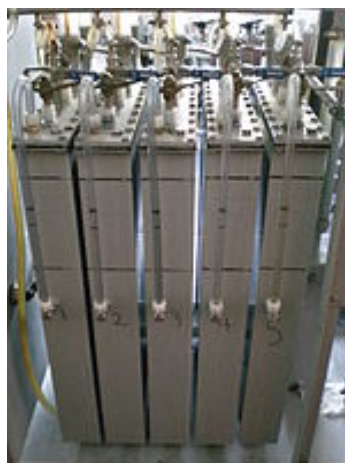
Celle industriali moderne per l'elettrolisi dell'acqua.
