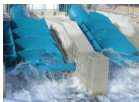
Impianto idroelettrico a coclea
